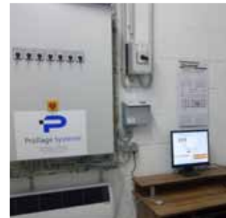
Schaltanlage mit Fütterungscomputer PR-Feed-Control
