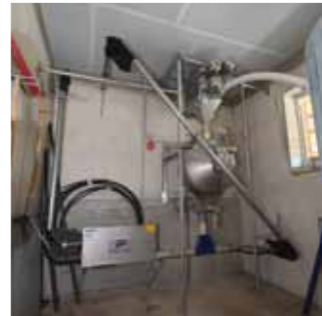
Schnell-/Wiegemischer mit Mehrfachkontrolleinheit
