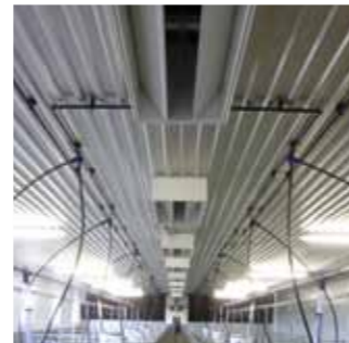
Zulufteinlassventile für Schlitzgangslüftung
