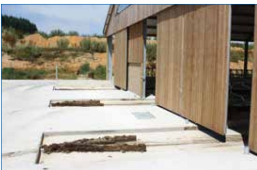
Faltschieber in Parkstellung vor dem Stall
