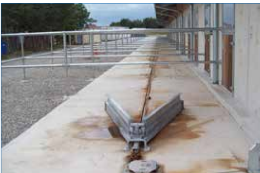
Faltschieber in Sonderausführung im Paddock
