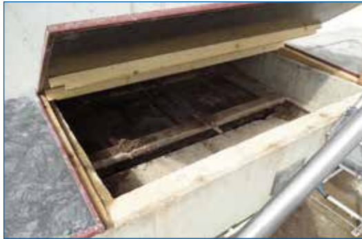
Unterflurschieber über Abwurf - Pig Port
